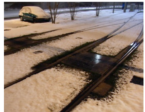
Aiguillages de rails chauffant pour éviter le gel du mécanisme.
